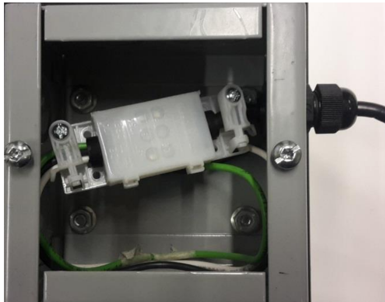
Fig. 43 Collegamenti elettrici finiti nel proiettore 74-00013-01
